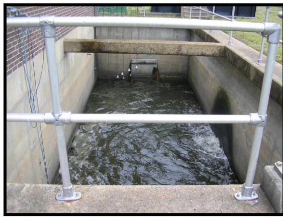
Effluent PS Wetwell
